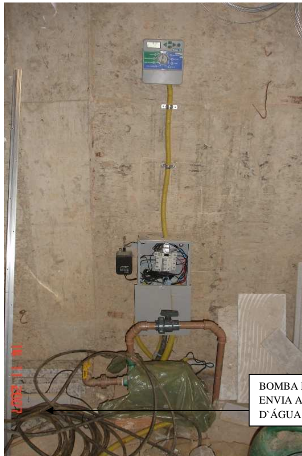
FIGURA 12: Pannel de controle do sistema de irrigação FONTE: Silveira, 2007
