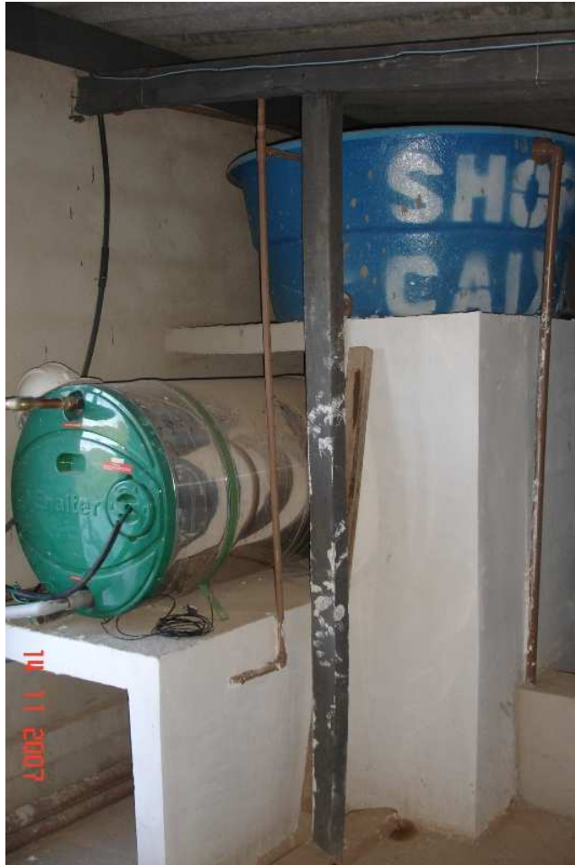
FIGURA 17 Reservatório para uso dos coletores solares FONTE: Silveira, 2007
