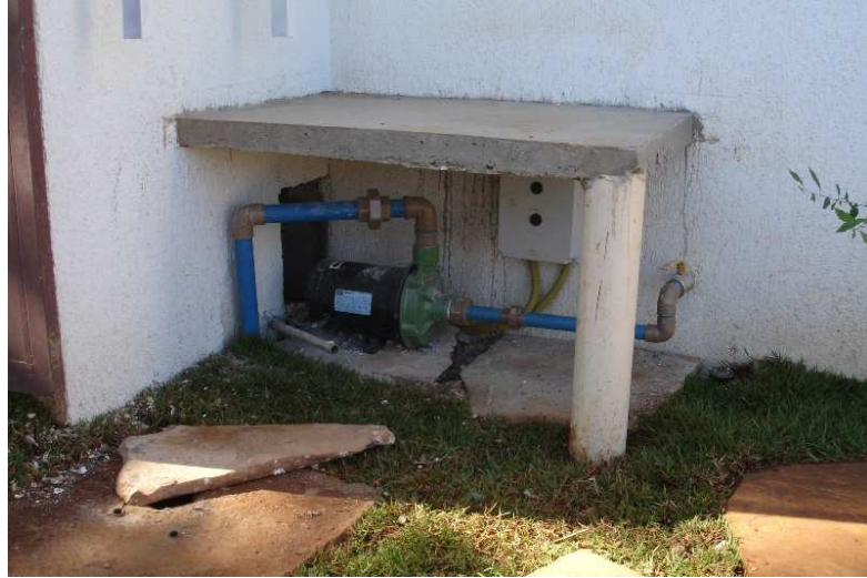
FIGURA 11: Bomba do sistema de irrigação FONTE: Silveira, 2007
