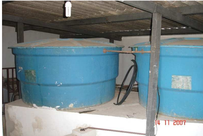
FIGURA 15: Reservatórios FONTE: Silveira, 2007
